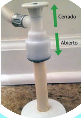
Llave de paso de Inodoro (casas nuevas)
