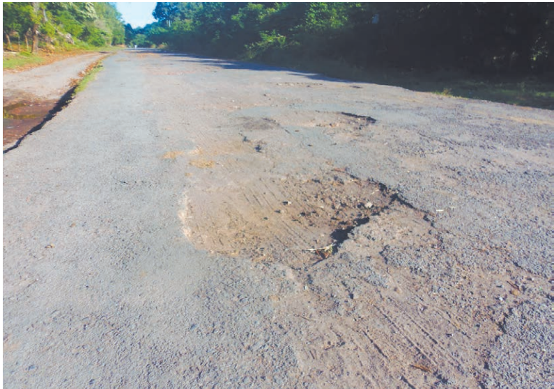
Son aproximadamente dos kilómetros de vía los que se encuentran en mal estado. Los pobladores pidieron atención urgente.
