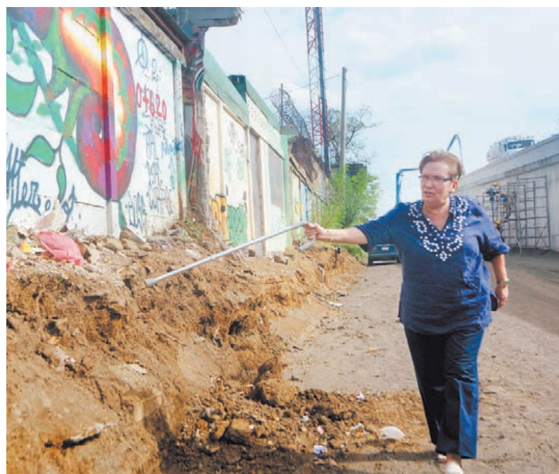
Maritza Zapata muestra cómo fácilmente se desmorona la tierra en la base de los muros y que ella considera han quedado debilitados.
