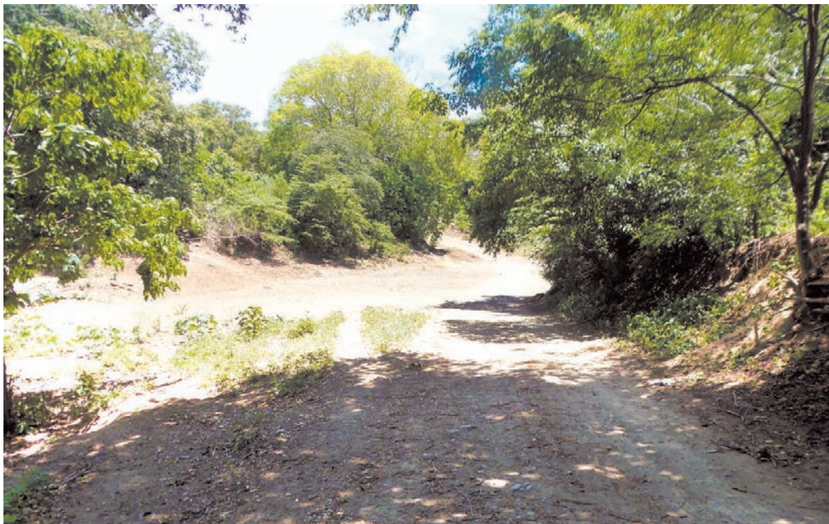
Las obras iniciales del megaproyecto canalero en la zona de Brito, Rivas, en el Pacífico —a ocho meses de haber sido iniciadas—, ya se encuentran deterioradas.
