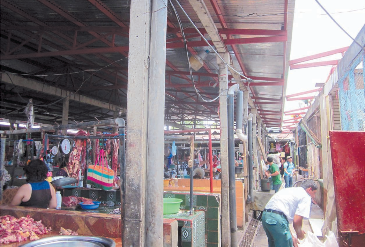
El sector carne ya tiene el zinc nuevo. En este sitio había muchas quejas de que el agua de lluvia se pasaba sin problemas, pues la anterior estructura parecía “pascón”.
