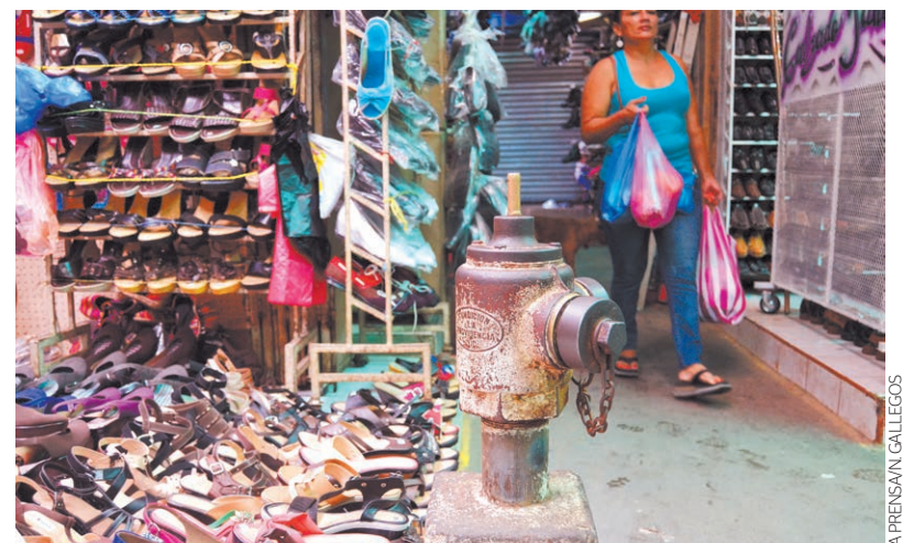
Los dos hidrantes que se ubican en el mercado de Masaya están obsoletos desde hace varios años, según los comerciantes.
