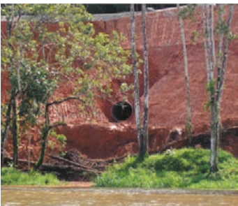
El trazado de la carretera no cumple con los requerimientos topográficos y ambientales.
