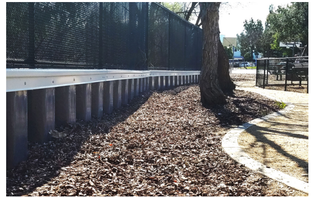
Muro de tablestacas de vinilo instalado junto a Rock Springs Park De acuerdo con las alternativas preferidas para el tramo 8, se ampliará y elevará el muro de tablestacas de vinilo.
